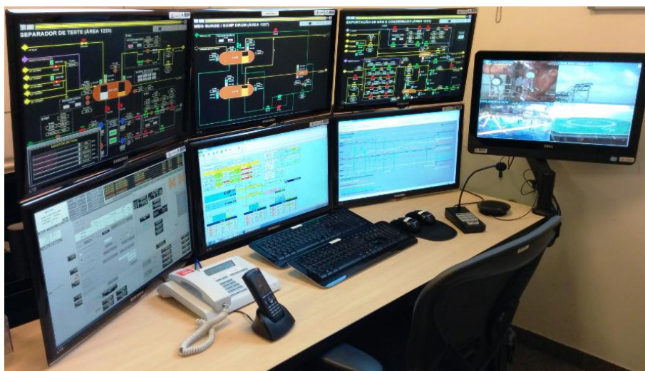
Figura 29 : Sala de controle remoto em terra da plataforma P-1
